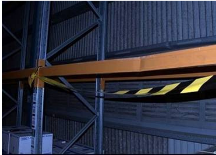
Rys.9. Przykład uszkodzenia trawersy regału magazynowego. Źródło: www.inspectarack.com
