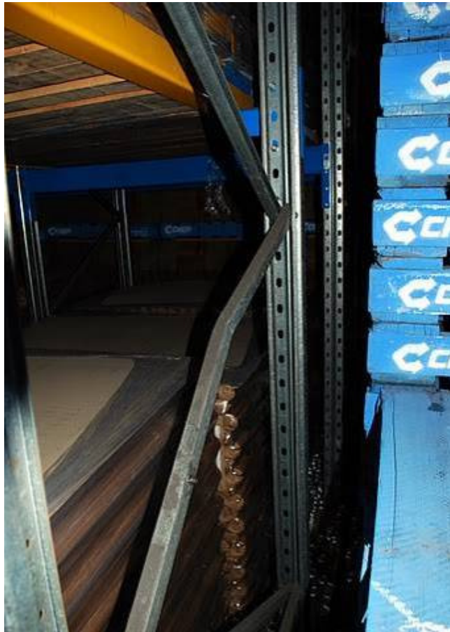
Rys.6. Przykład uszkodzenia kratownicy ramy nośnej regału magazynowego. Źródło: www.inspectarack.com
