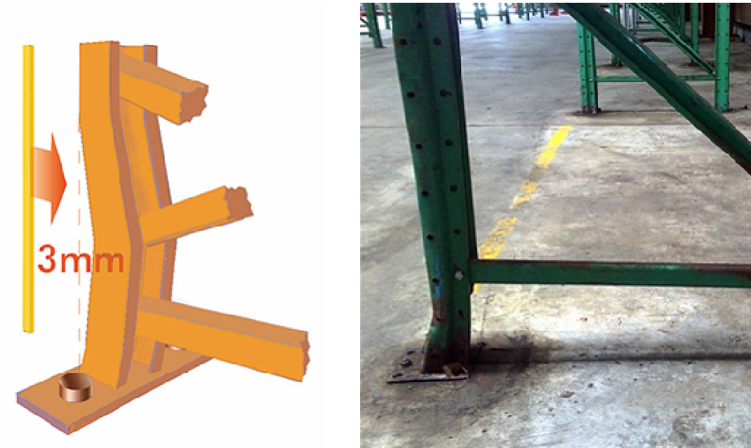
Rys.5. Wizualizacja kierunku pomiaru w płaszczyźnie prostopadłej do korytarza wraz z przykładem tego typu uszkodzenia regału magazynowego. Źródło: www.inspectarack.com
